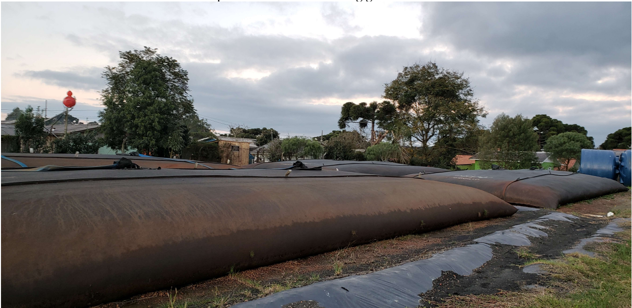
Figura 10 – Bag geotêxtil de 250 m 3 instalado no município de Curitibanos. Detalhe para a camada de drenagem em pedra britada abaixo do bag geotêxtil .
