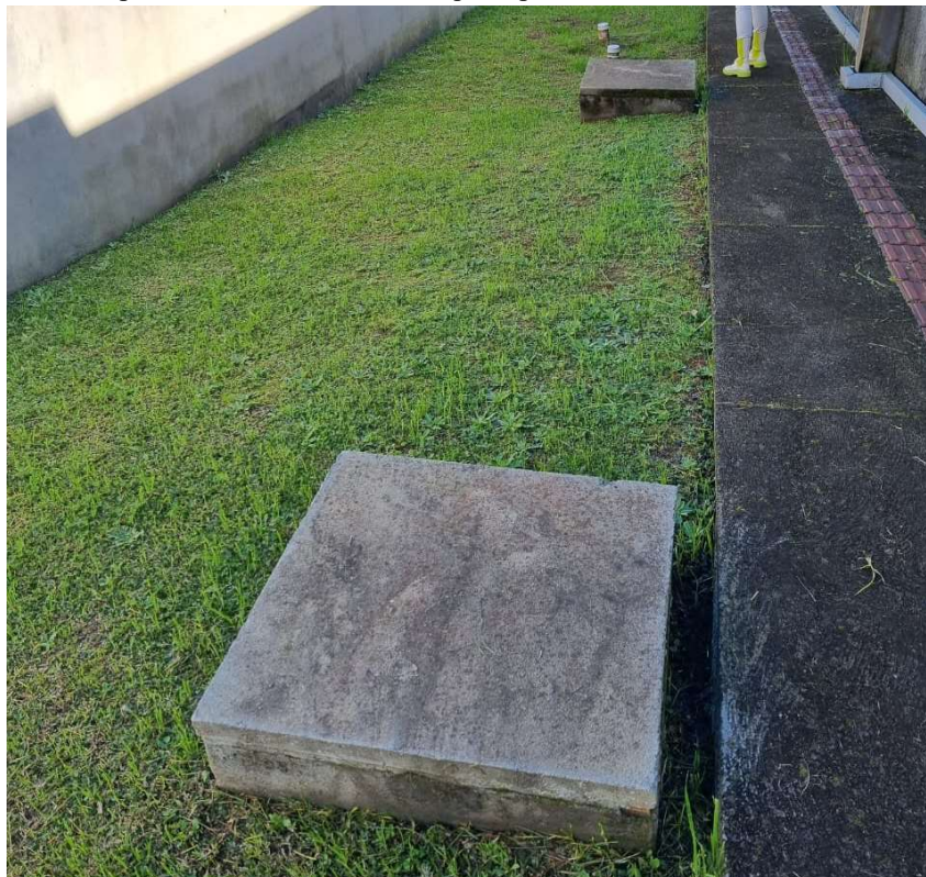
Figura 14 - Exemplo de sistema contendo tanque séptico e filtro anaeróbio em Anita Garibaldi.
