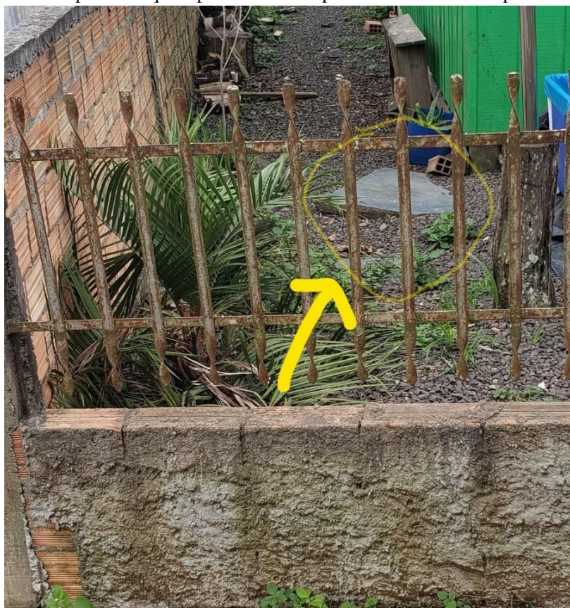
Figura 16 - Exemplo de tanque séptico informado pelo morador no município de Ponte Alta.
