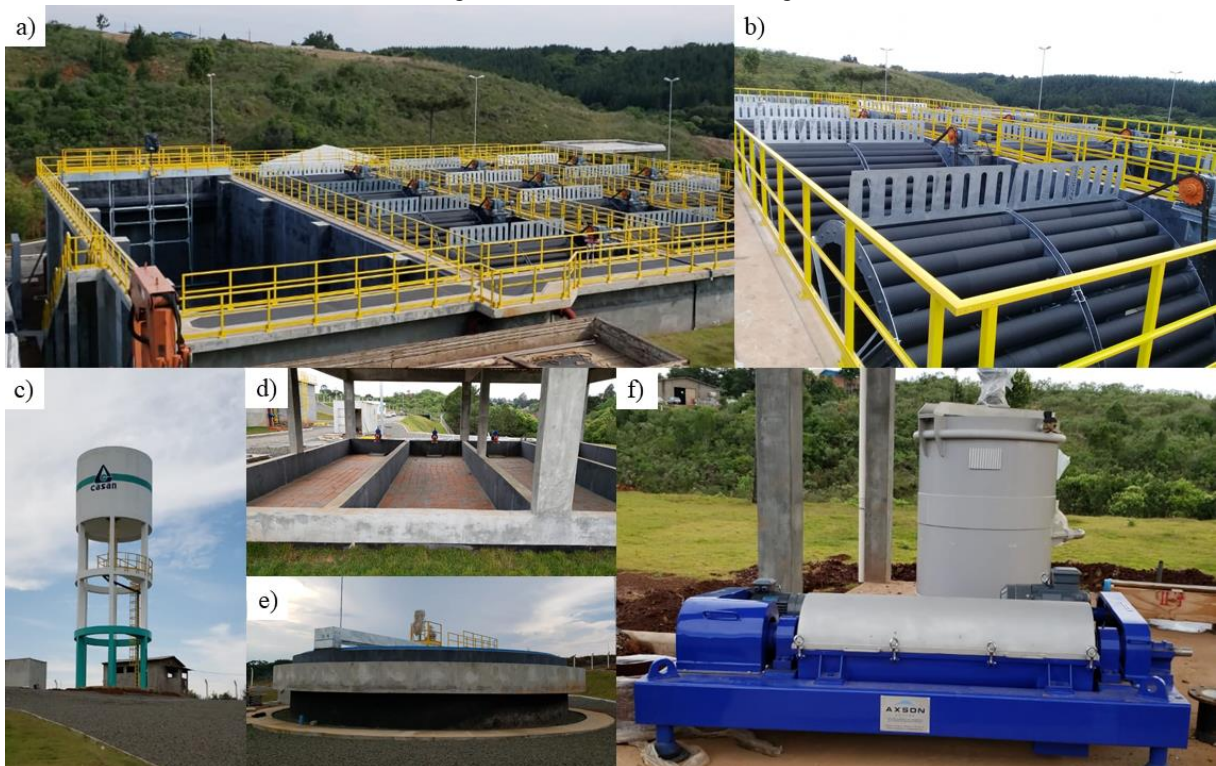
Figura 42 – ETE de Curitibaanos. a) reator aeróbio (direita) e sedimentador secundário (esquerda), b) sistema de aeração por discos e membrana perfurada, c) reservatório para o esgoto tratado por processo terciário, d) leito de secagem, e) adensador e f) centrífuga.
