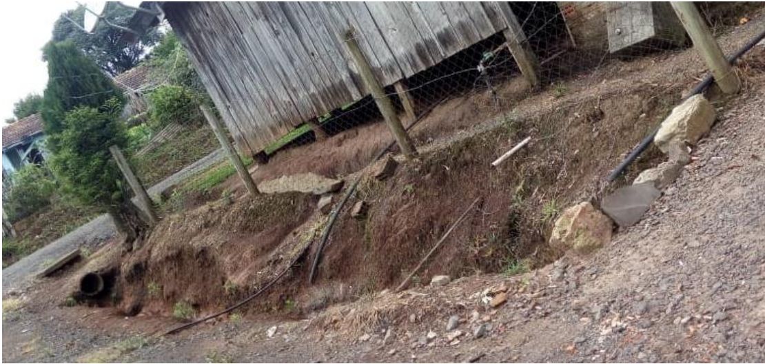
Figura 23 - Esgoto sendo aplicado diretamente na rede pluvial.
