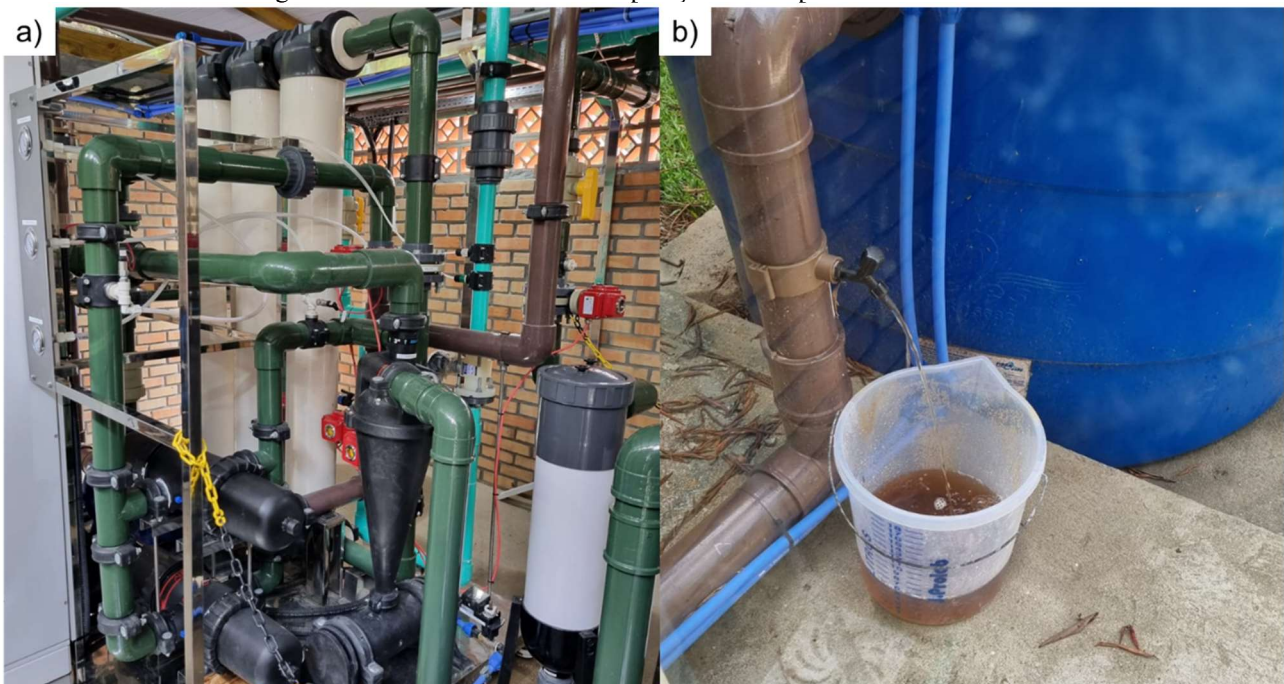
Figura 14 – a) Visão do sistema de membranas de UF instalado na região da Grande Florianópolis. b) Subproduto gerado no tratamento devido às operações de limpeza da membrana.
