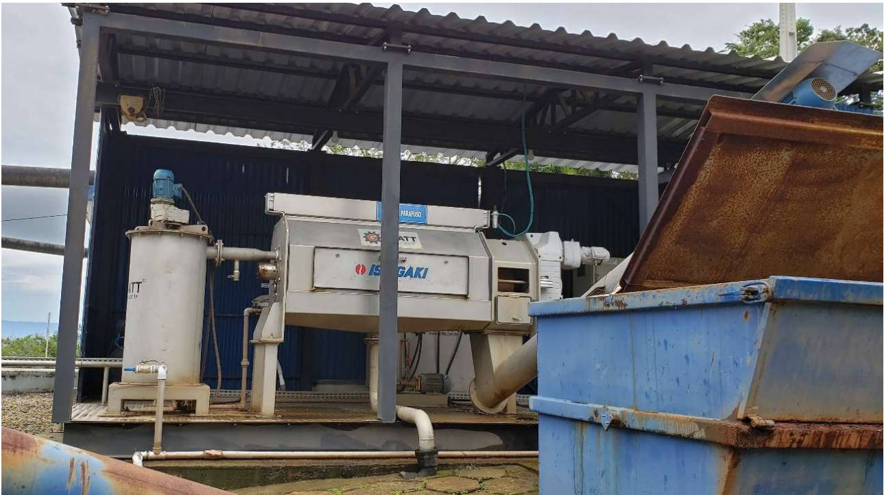
Figura 11 – Exemplo de prensa desaguadora de discos (ao centro) instalada em uma ETA na região sul de Santa Catarina. Detalhe para o tanque de mistura com polímero à esquerda e container para recebimento do lodo desidratado à direita.
