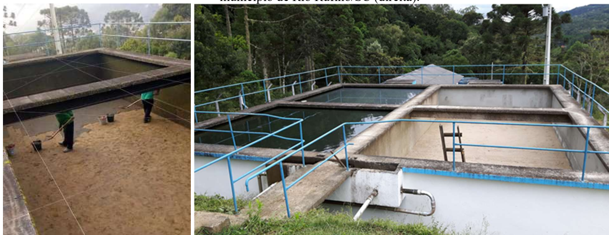
Figura 13 - Operação de remoção da camada Schmutzdecke (esquerda) e visão de uma unidade de Filtração Lenta no município de Rio Rufino/SC (direita).
