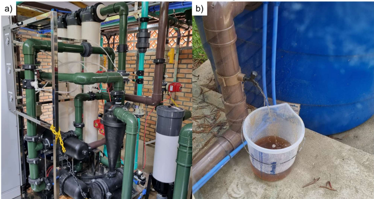
Figura 10 – a) Visão do sistema de membranas de UF instalado na região da Grande Florianópolis. b) Subproduto gerado no tratamento devido às operações de limpeza da membrana.
