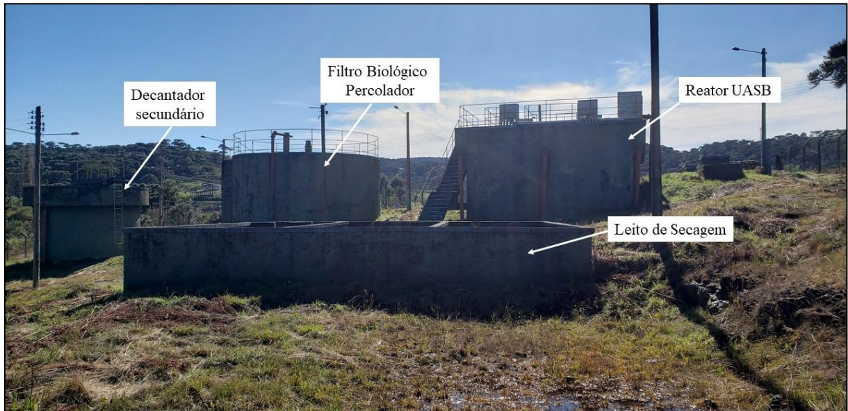
Figura 8 - Reatores que compõem o sistema de tratamento de esgoto de Urupema, decantador secundário e leito de secagem para o gerenciamento dos subprodutos.
