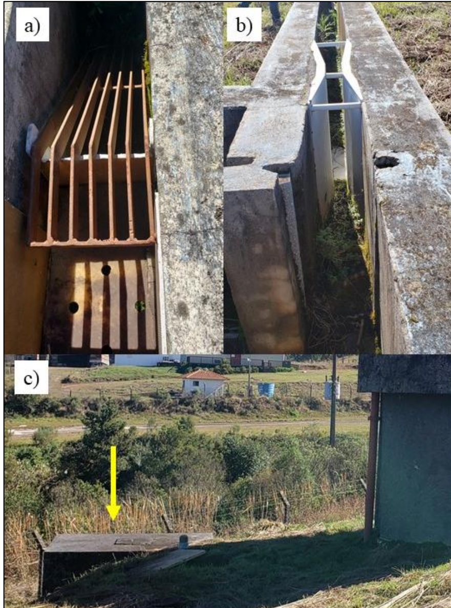
Figura 7 - Dispositivos constituintes do sistema de tratamento de esgoto de Urupema. a) gradeamento, b) caixa de areia e medidor Parshall e, c) tanque de contato.
