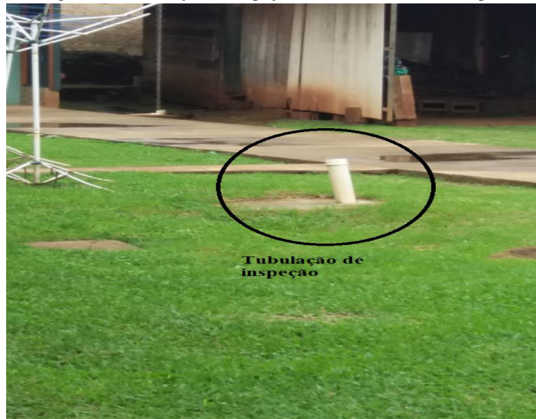
Figura 21 - Tubulação de inspeção em residência do município.
