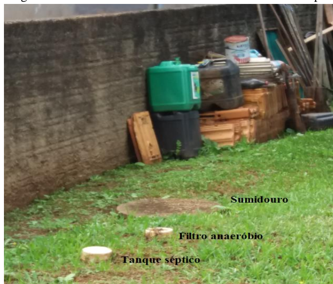
Figura 16 - Sistema TS + FS + S em residência do município.
