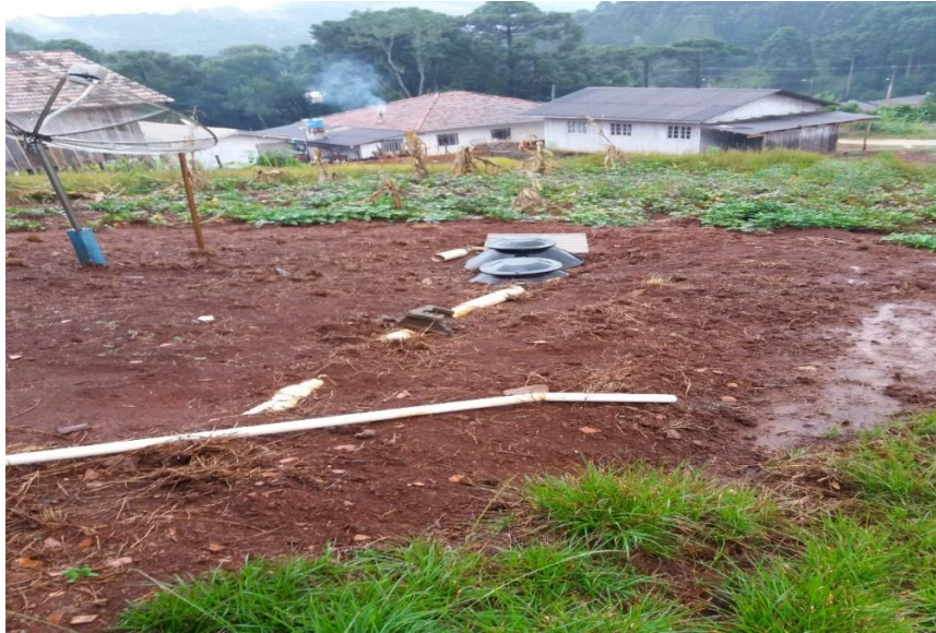
Figura 15 - Sistema de tratamento pré-fabricado em residência.
