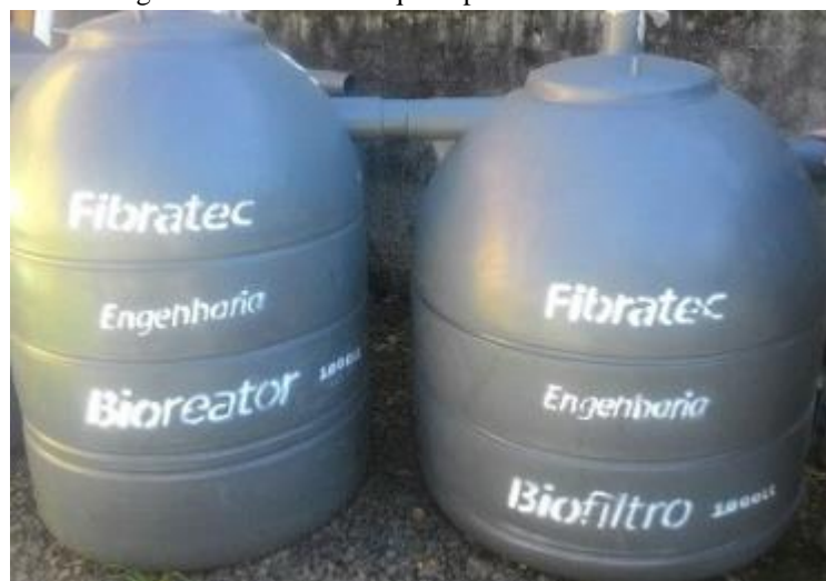
Figura 20 - Sistema tanque séptico e filtro anaeróbio.
