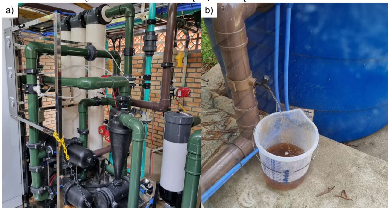
Figura 14 – a) Visão do sistema de membranas de UF instalado na região da Grande Florianópolis. b) Subproduto gerado no tratamento devido às operações de limpeza da membrana.
