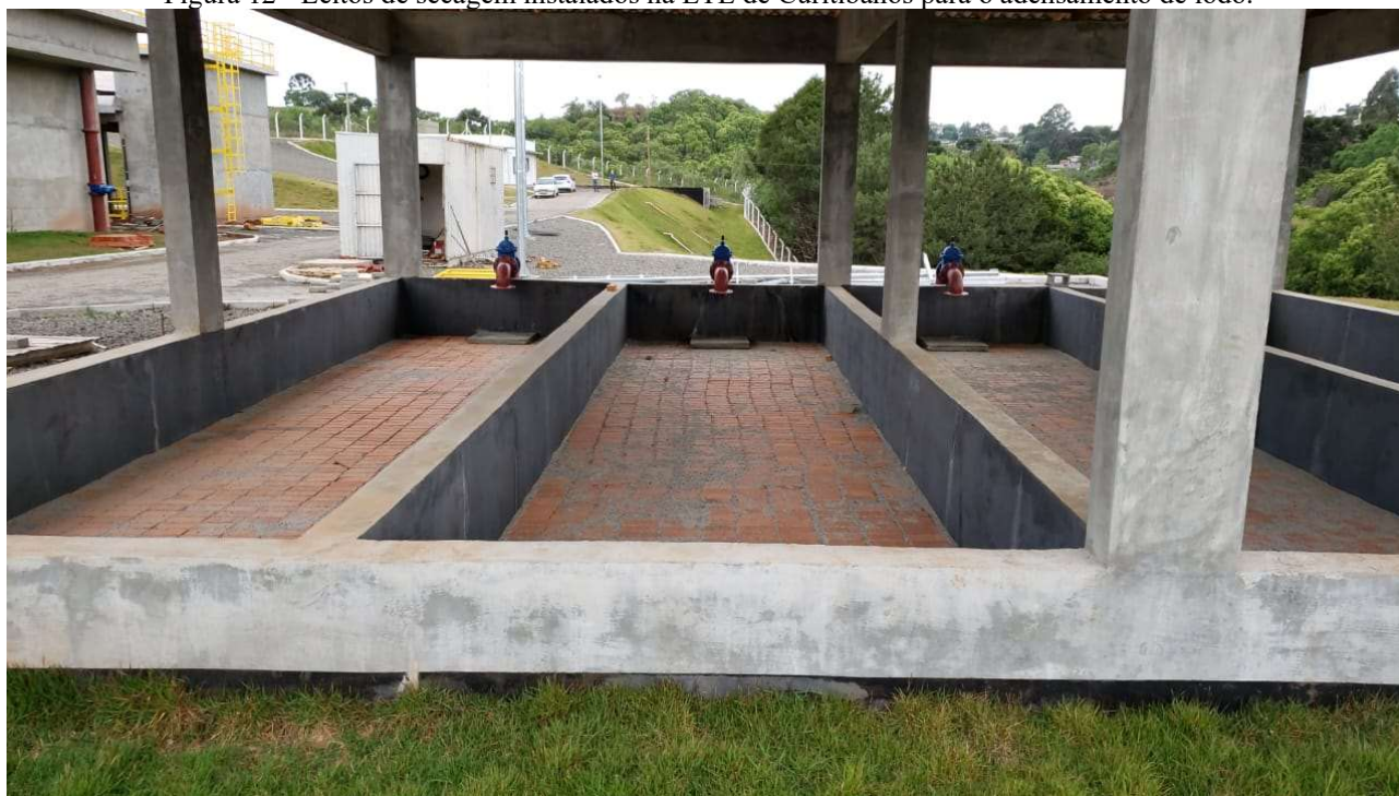
Figura 12 - Leitões de secagem instalados na ETE de Curitiba para o adensamento de lodo.
