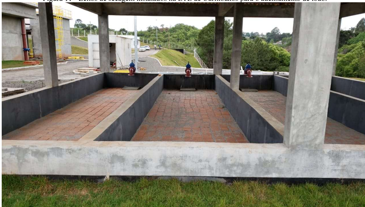
Figura 11 - Leitões de secagem instalados na ETE de Curitiba para o adensamento de lodo.
