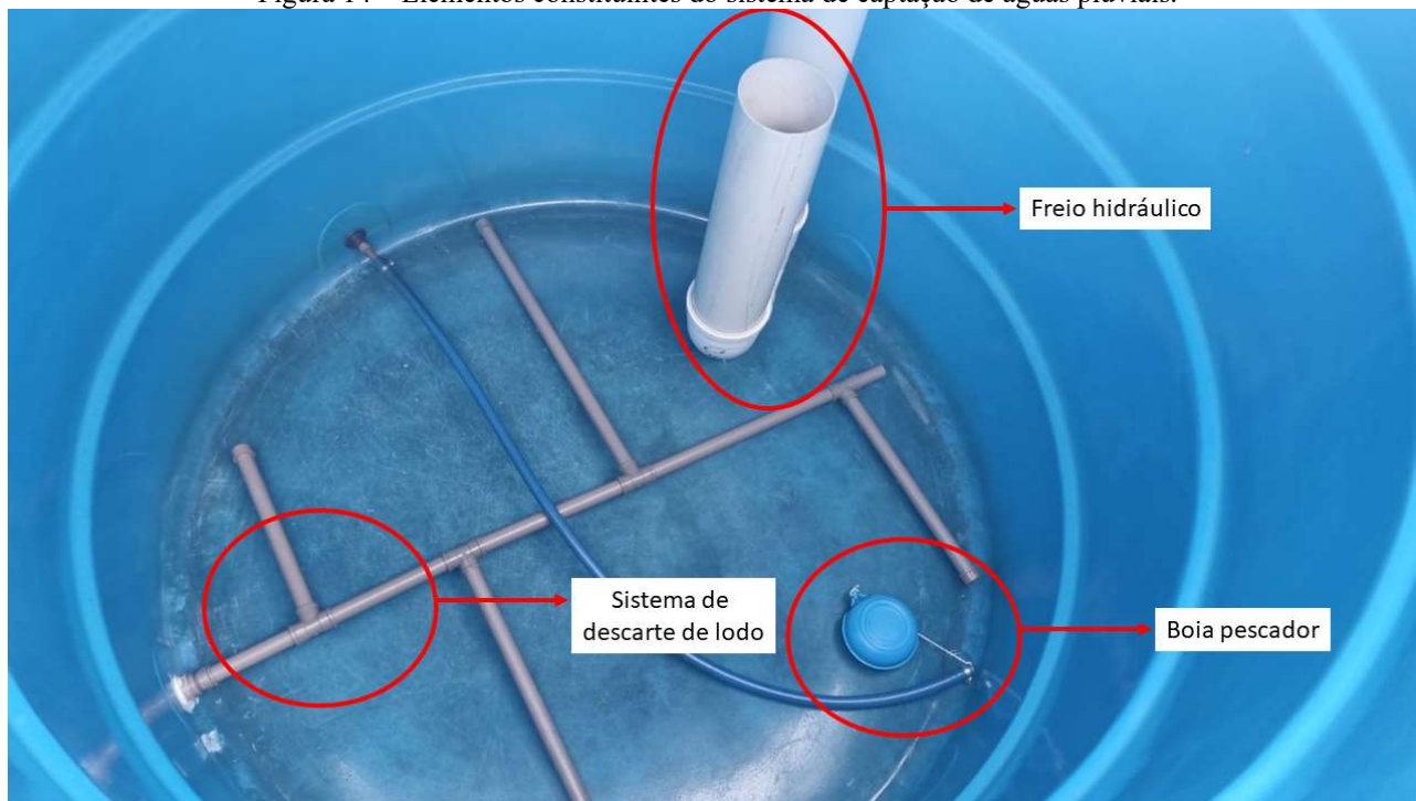
Figura 14 – Elementos constituintes do sistema de captação de águas pluviais.
