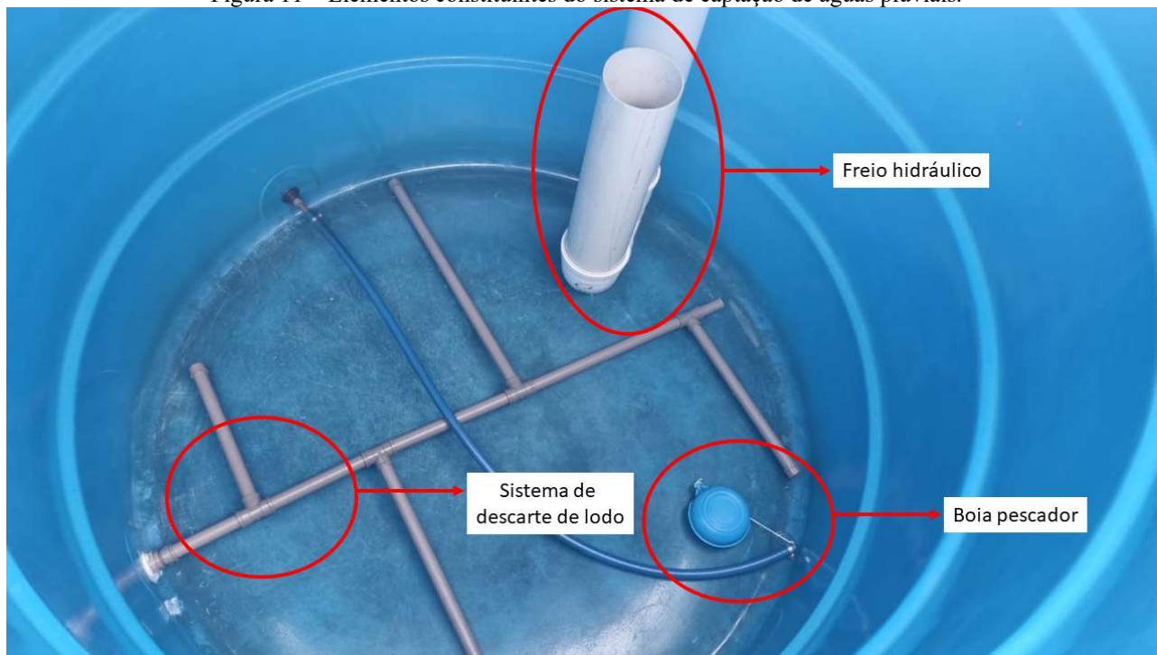
Figura 11 – Elementos constituintes do sistema de captação de águas pluviais.
