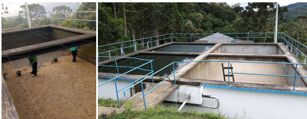
Figura 9 - Operação de remoção da camada Schmutzdecke (esquerda) e visão de uma unidade de Filtração Lenta no município de Rio Rufino/SC (direita).
