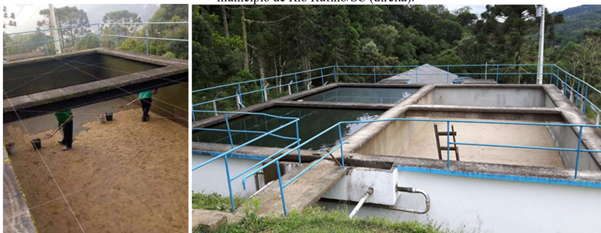
Figura 8 - Operação de remoção da camada Schmutzdecke (esquerda) e visão de uma unidade de Filtração Lenta no município de Rio Rufino/SC (direita).
